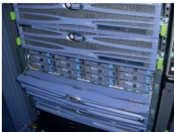
Baies de stockage du cluster
